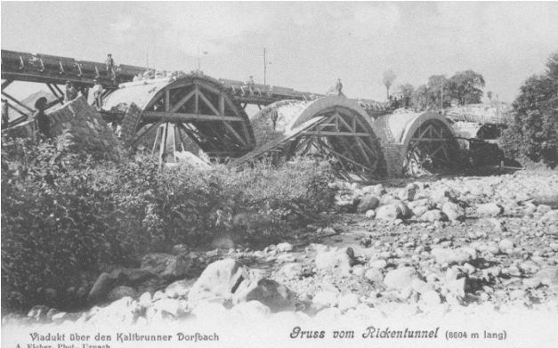
Rickentunnel-Bahnbau, Viadukt über den Kaltbrunner Dorfbach, Bauarbeiter am Arbeiten, Foto ca. 1904 - 1910, Fotograf A. Eicher Uznach. [Staatsarchiv St. Gallen]
